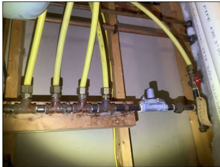
CSST gas pipes
