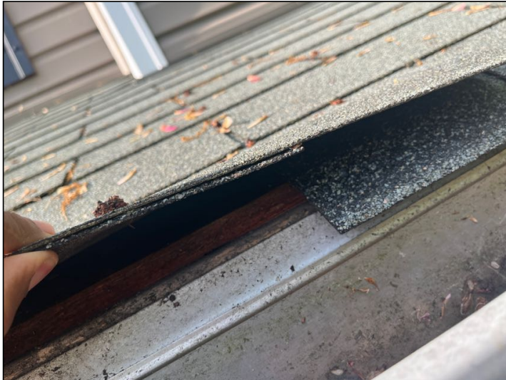
Missing drip edge
